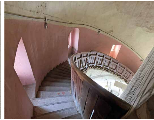
Immer weiter geht es nach oben. Das hölzerne Geländer der Treppe ist im Originalzustand erhalten. Rechts der gemauerte Aufzugschacht
