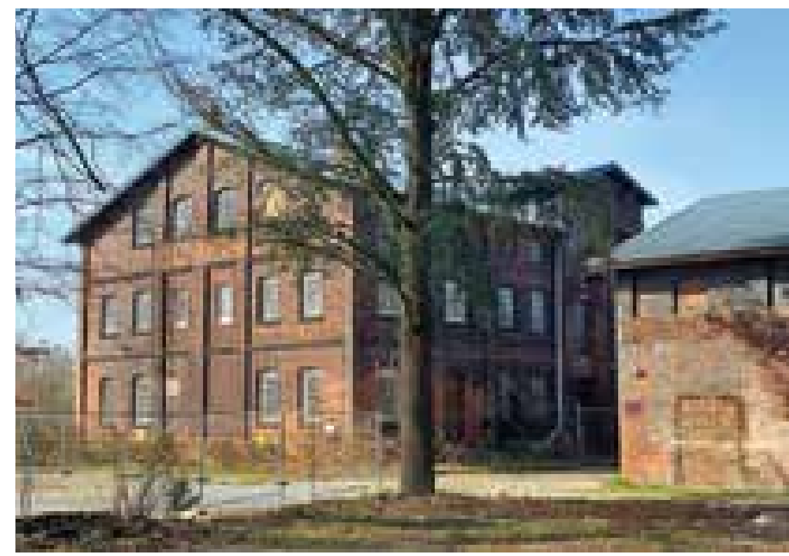
Chemische Fabrik/Knochenmühle, seit 2022 Leerstand wegen akuter Einsturzgefahr
